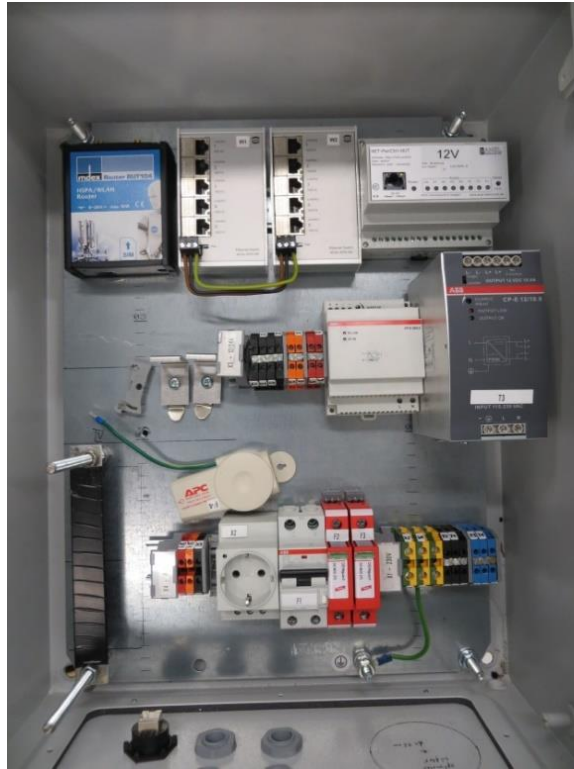
Abbildung 22: Teile der Innenanlage am Oberbilker Markt Düsseldorf. (BxHxT): 0,4m x 0,6m x 0,2m
